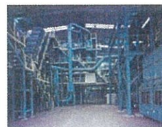
プラスチックリサイクル設備 <事前処理設備>
